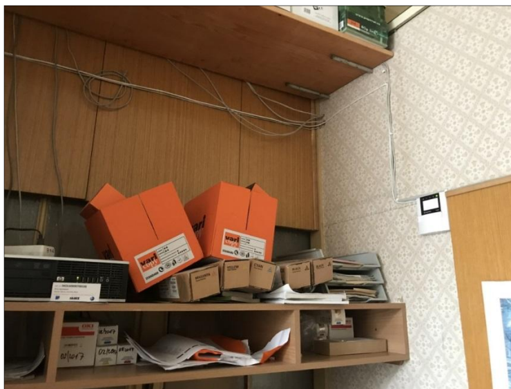
Foto nevhodné praxe – instalace v rozporu s platnými ČSN
